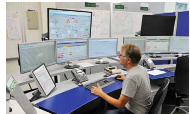
Alles im Blick: Die Wasserversorgung wird in der Leitstelle der IBC Energie Wasser Chur überwacht.
